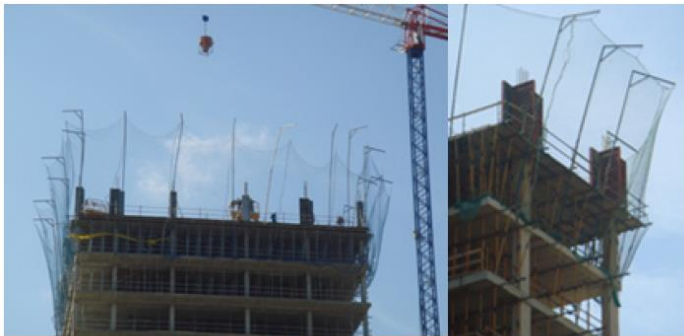
Figura 30 - Sistema Limitador de Queda de Altura por Rede
