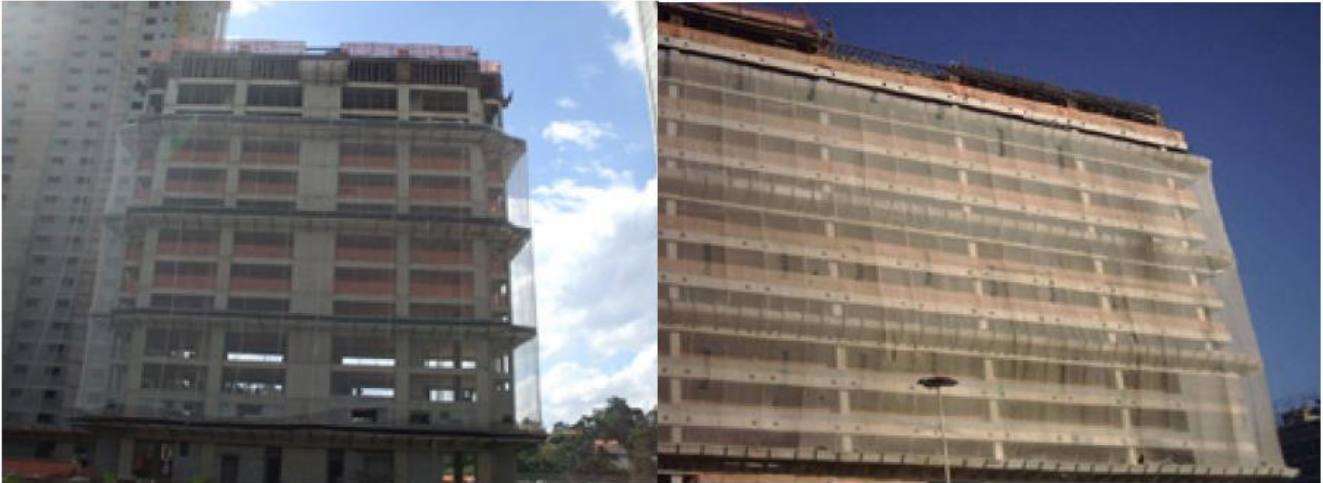
Figura 28 - Plataforma de Proteção e Tela
